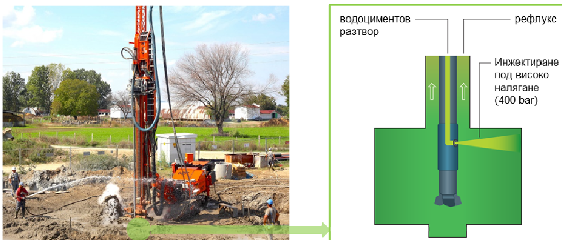
Фиг. 1 Принципна постановка за изпълнение на цилиндрични каменовидни тела и подобряване на механичните почвени параметри посредством инжектиране на цементов разтвор под високо налягане („джет-граутинг“) – [9]
