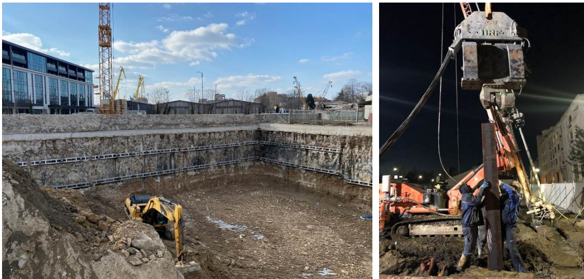
Фиг. 7 Изпълнение на двуредово подпряна укрепителна конструкция („цименто-почвена стена“) изпълнена по система „джет-гарутинг“ – град Бургас
