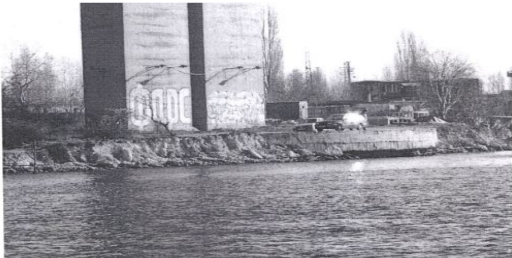
Фиг. 5. Снимка на фундамент № 27, силно засегнат от странична ерозия и с подкопана подпорна стена
